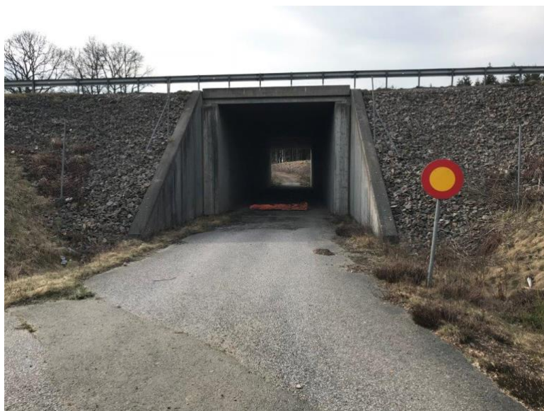
Figur 19. Port under E4:an som används av faunan för passage som befinner sig i direkt anslutning till väg med hastighetsgräns 90 km/t.
